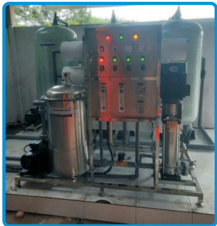
Hệ thống RO 5m³/giờ tại Nhà máy nước đá tinh khiết Đàm Văn Tông (Gò Dầu, Tây Ninh)
