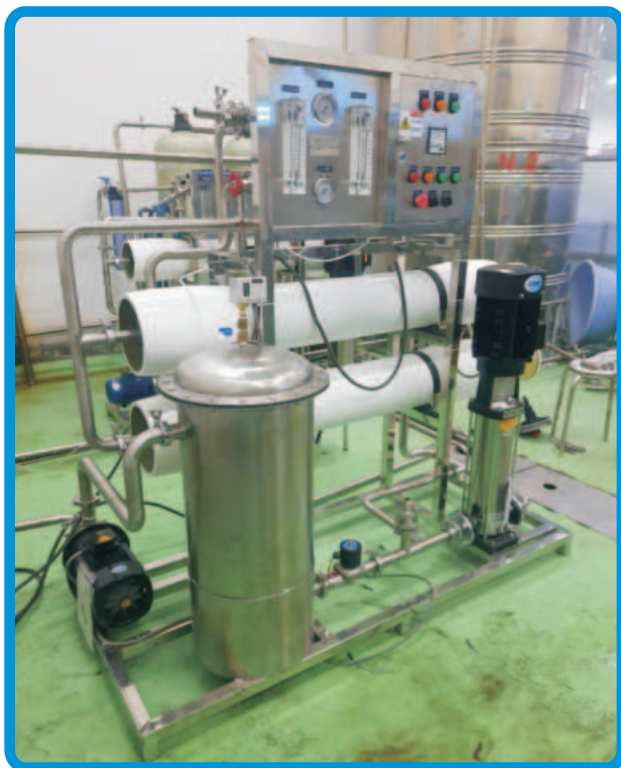
Hệ thống RO 3m 3 /giờ tại Nhà máy mía đường Tây Ninh
